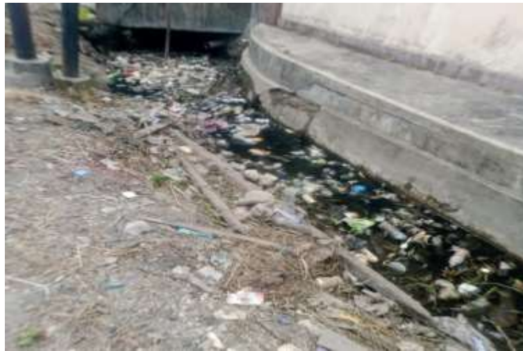
Gambar 1.2 Kondisi Saluran Air di Bungus Teluk Kabung yang Dipenuhi Sampah Plastik dan Botol Bekas
